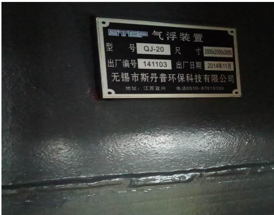
图 4-3 污水处理气浮装置
